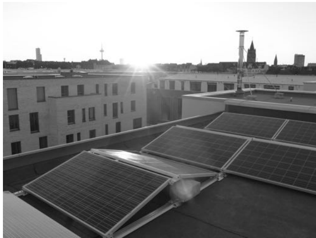
Photovoltaikanlage auf dem Dach der Baugemeinschaft WUNSCHNACHBARN, Auf dem Stahlseil 7
